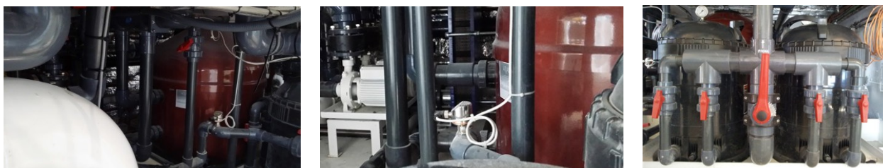
Luxury pool Sun deck mega yacht di 66 m Filtro con vetrosfera e Prefiltrazione acqua di mare.
